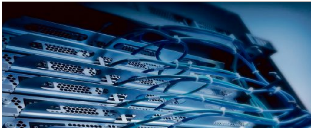
Skalierbarkeit: IT-Ressourcen werden bereitgestellt, sobald die Anforderungen steigen (Bild A)
