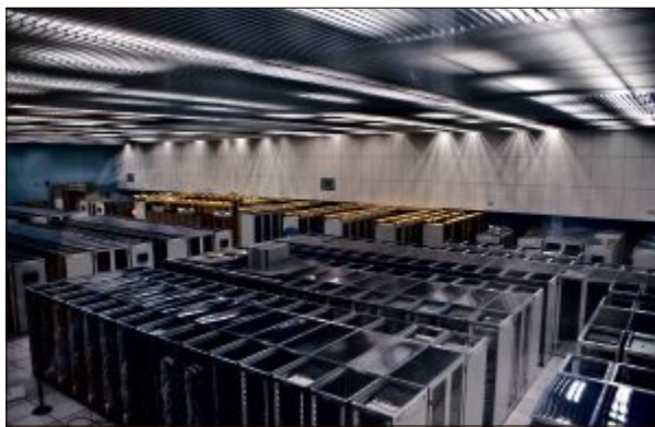
Provider: Rechenzentrum mit hochverfügbarer Infrastruktur (Bild D)
